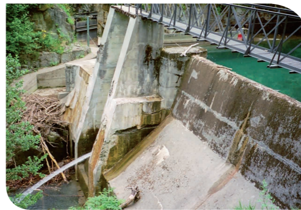
Prise d'eau de Lartigues (09) Rupture de la continuité écologique
