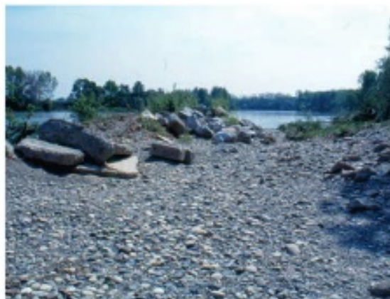
2000 Les enrochements de la prise amont sont démantelés par la crue trentennale
