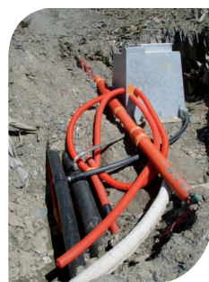
Equipements de canons à neige Peyresourde Balestas (65) © - Uminate 65
